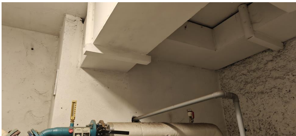
Zone dans le CPCU de la fuite observée dans la réserve au sous-sol -2 le 08/10/2024
