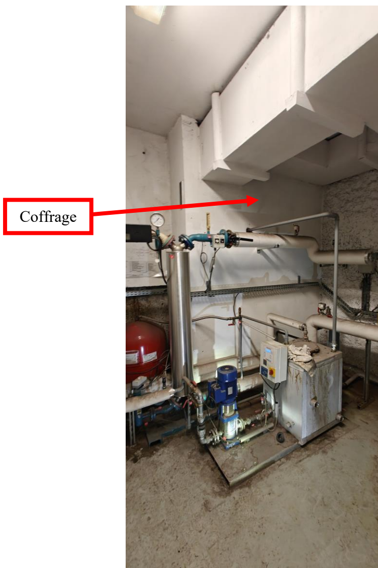
Zone dans le CPCU de la fuite observée dans la réserve au sous-sol -2 le 08/10/2024
