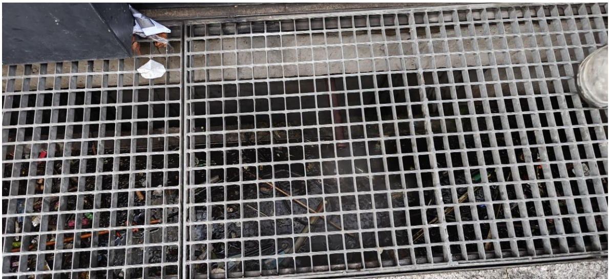
Grille du puit de ventilation au RDC dans la Rue de Tanger responsable de la fuite observée dans la réserve au sous-sol -2
