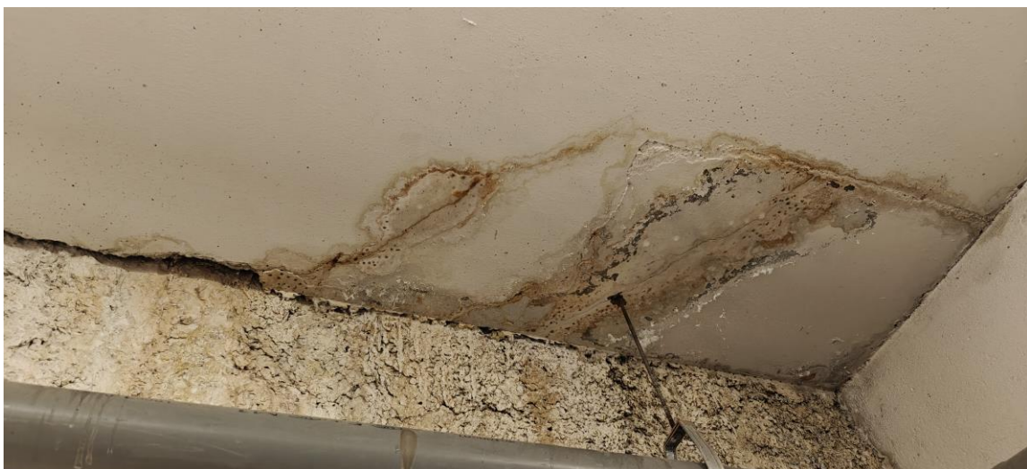
Zone de la fuite observée dans la réserve au sous-sol -2
