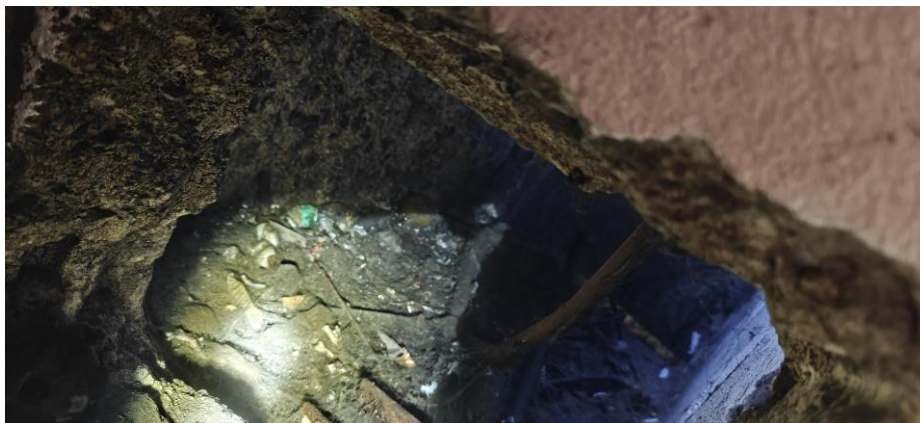
Zone dans le CPCU de la fuite observée dans la réserve au sous-sol -2 le 08/10/2024
