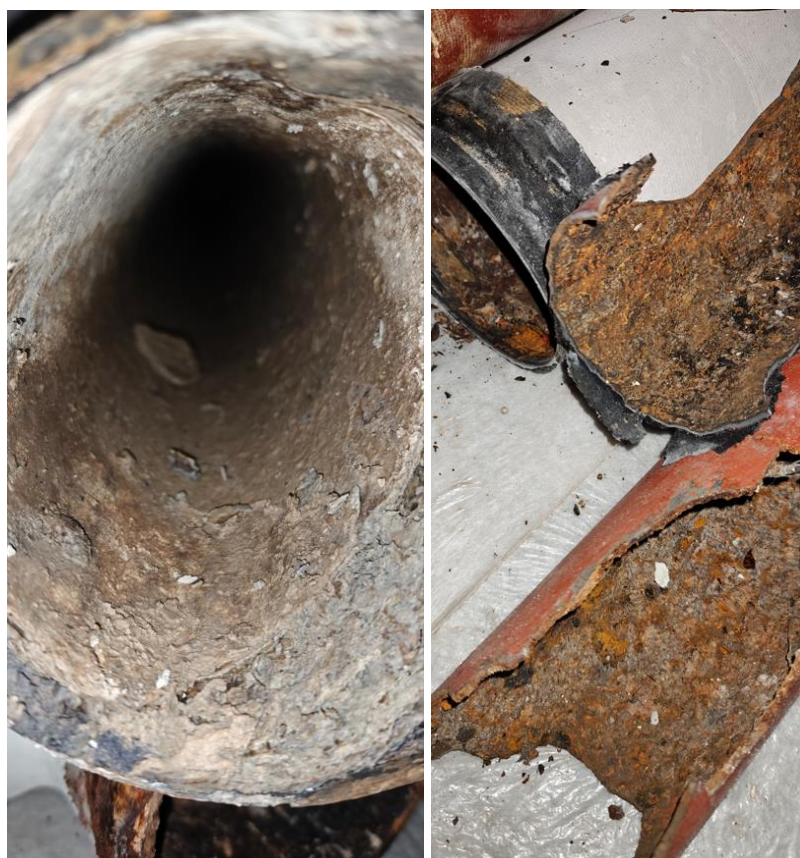
Photos des dépôts observés dans les anciennes canalisations le 19/12/2024
