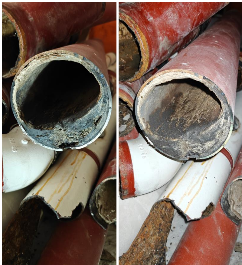
Photos des dépôts observés dans les anciennes canalisations le 19/12/2024
