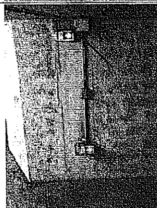
Photo n° PhA004 Localisation : Sous-sol -4 - Parking Ouvrage : Murs et cloisons Partie d'ouvrage : Enduits/Béton Description : Enduits/Béton Localisation sur croquis : Point004
