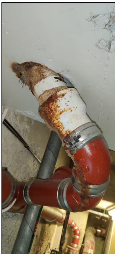
Photo d'une colonne en très mauvais état
