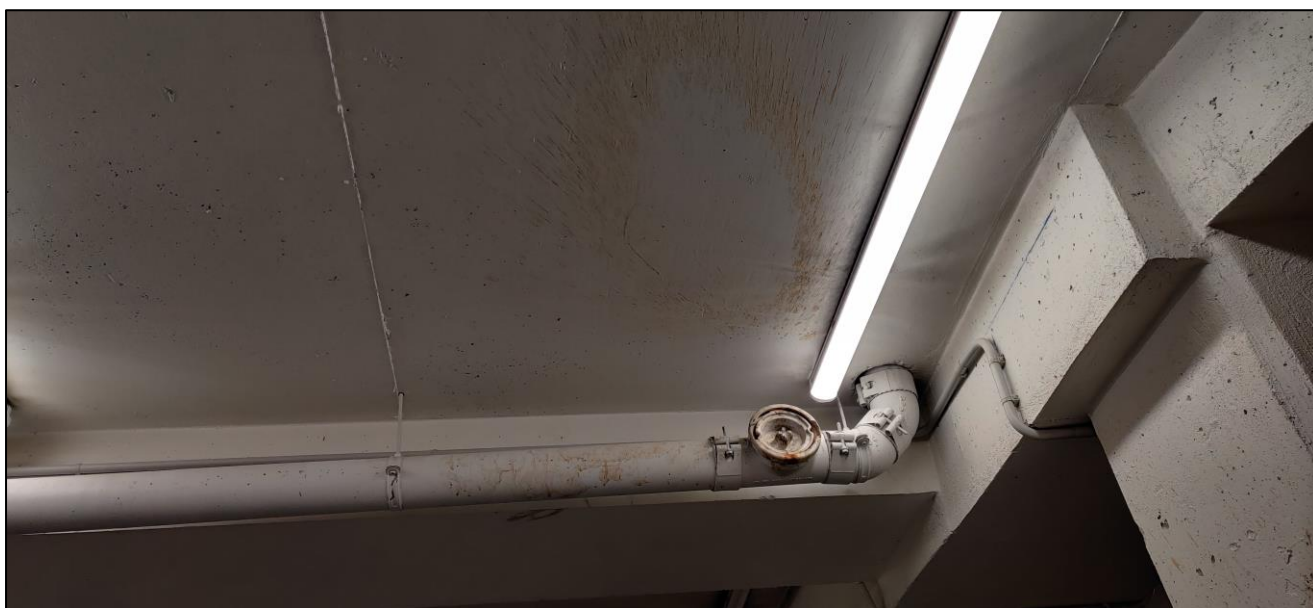
Photo d'un des tronçons ayant été fuyard
