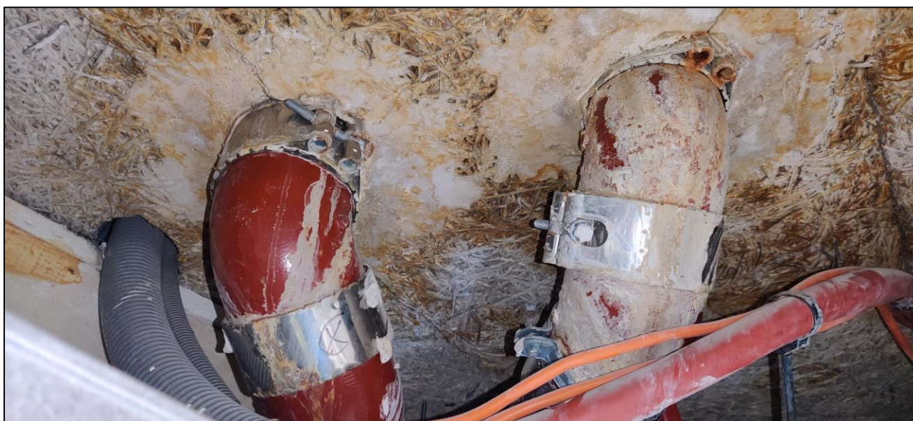
Photo de colonnes fuyardes
